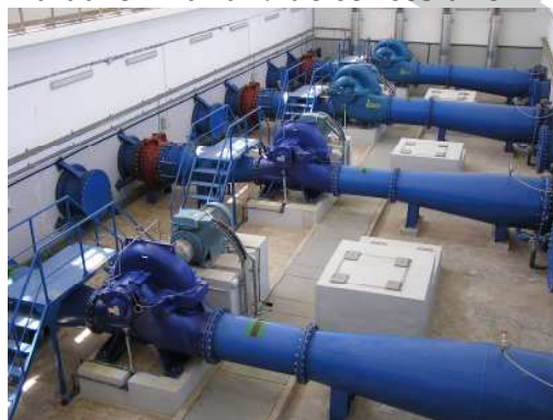
Uzina de pompare a statiei Crivina
